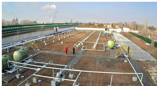
图1 国家管网集团成品油管道顺序输送甲醇705站综合试验平台
